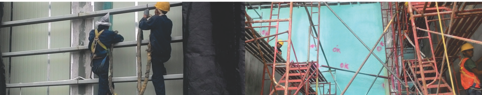
Cold Storage Cibitung
